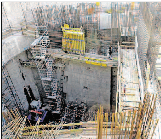
GIGANTISCHE PROPORTIONEN: Trotz mannigfaltiger Schwierigkeiten mit dem Baugrund soll die neue Turbine im Rheinkraftwerk Iffezheim Ende 2012 betriebsbereit sein. Foto: Kraft
